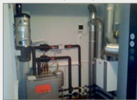
Primer sodobne kotlovnice s toplotno črpalko zemlja-voda, sistem rekuperacijskega prezračevanja in centralno sesalni sistem
