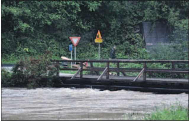
Leseni most je bil ob visokem vodostaju reke Mirne močno poškodovan. (Foto: arhiv Občine Sevnica)
