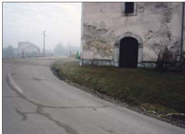
Stanje ceste pred obnovo
